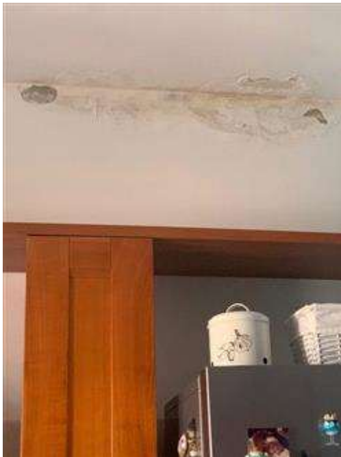
Presenza di umidità sul soffitto e zona alta del soggiorno
