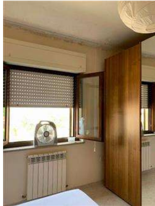
Umidità presente anche sul soffitto della stanza da letto.
