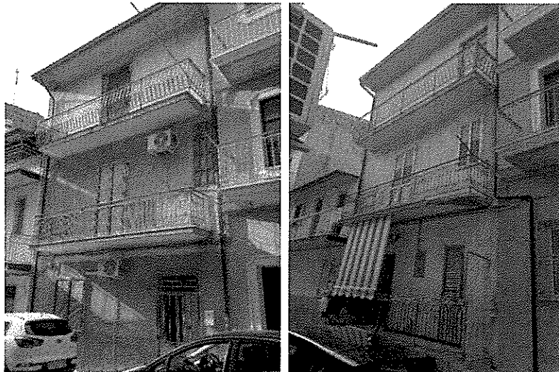
FOTO 1 e 2 – Facciata nord-ovest e facciata sud-est dell'abitazione in Cutro Trav. San Rocco n. 21.
