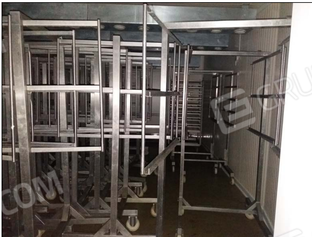
Foto n. 35: prospettiva ingresso cella frigorifera “celfr8”- unità “U1”
