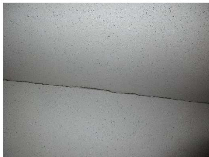
Foto n.5 – Locale ufficio – Lesione tra intradosso solaio e parete est– Lato interno
