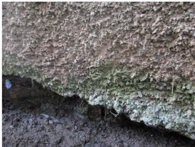
Foto n.16 – Locale Ufficio – Cedimento terreno lato est
