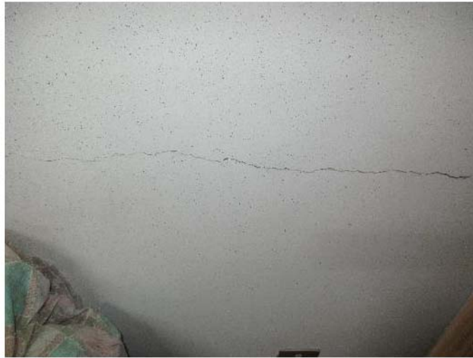
Foto n.6 – Locale ufficio – Parte bassa parete ovest – Lato interno
