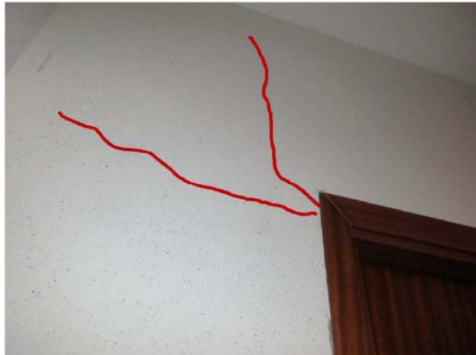
Foto n.10 – Disimpegno – Parte alta parete est – Lato interno
