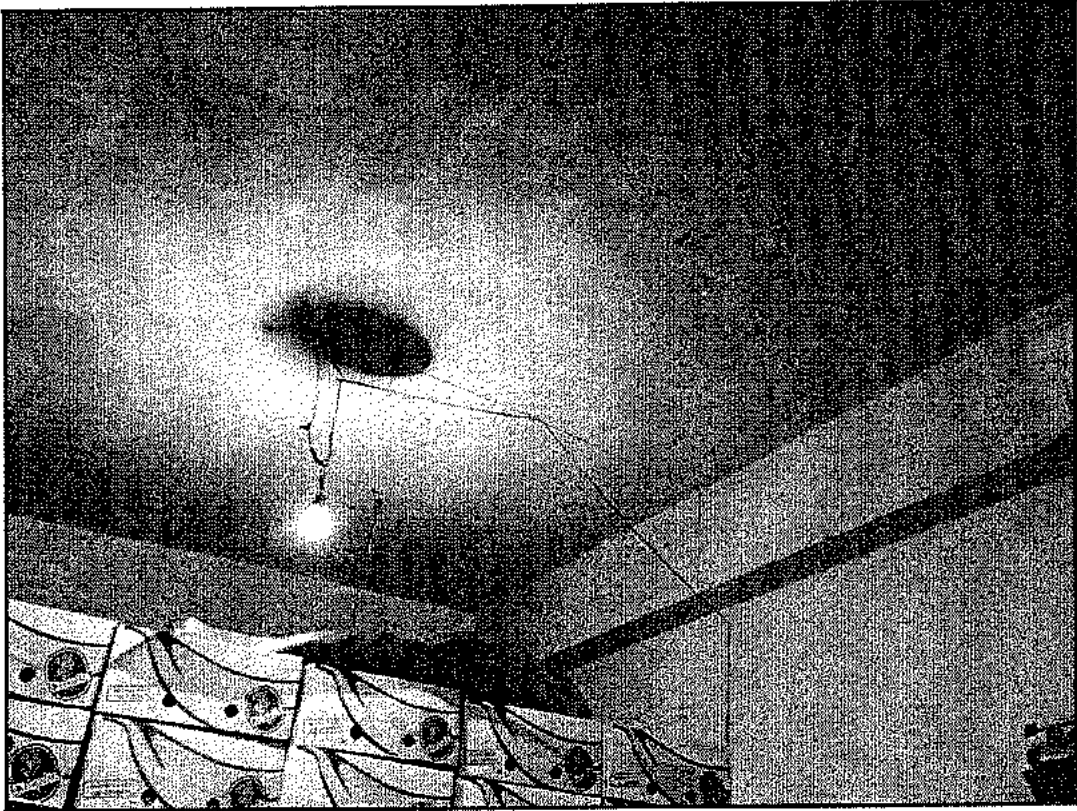
Foto n. 5: Particolare dell'impianto elettrico non conforme alla normativa vigente
