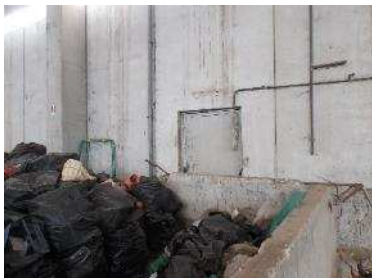
Foto n.°11 rottura illuminazione di sicurezza
