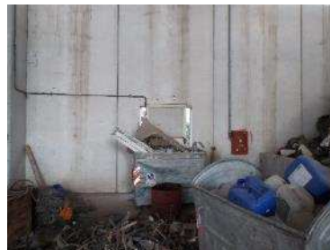
Foto n.°12 assenza manichetta impianto antincendio
