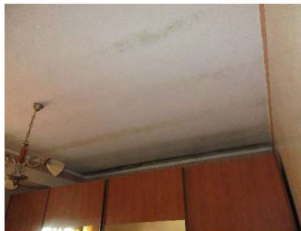
Foto n. 14 – Umidità presente nella camera da letto n. 2
