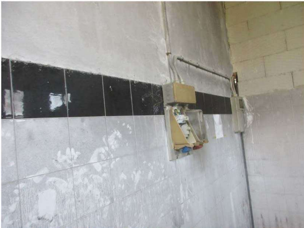
Foto 30: Immagine descrittiva dello stato dell'impiantistica elettrica
