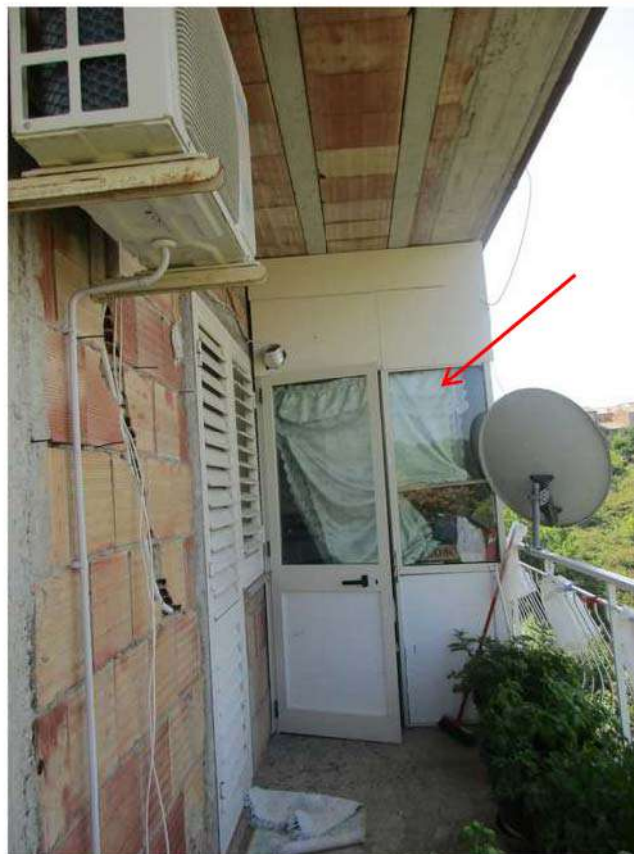
Foto 77: Balcone sul fronte sud del fabbricato: in evidenza il locale realizzato senza titolo edilizio
