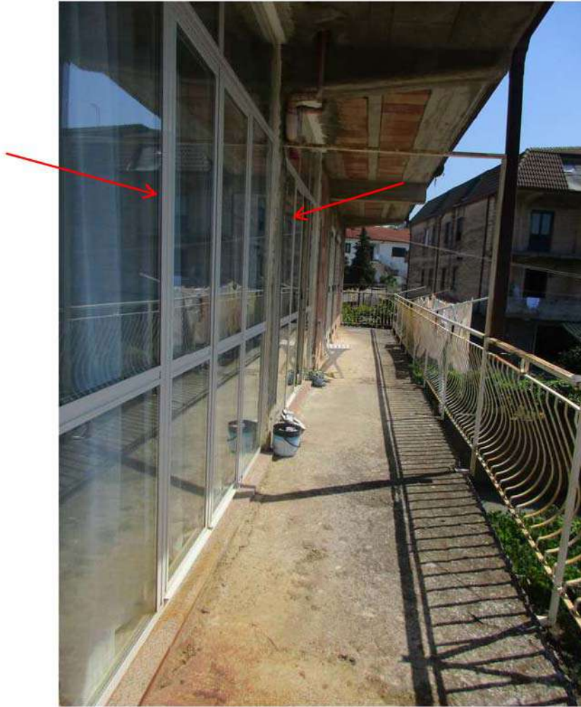
Foto 79: Il balcone sul fronte Sud del fabbricato: le vetrate poste a chiusura delle verande
