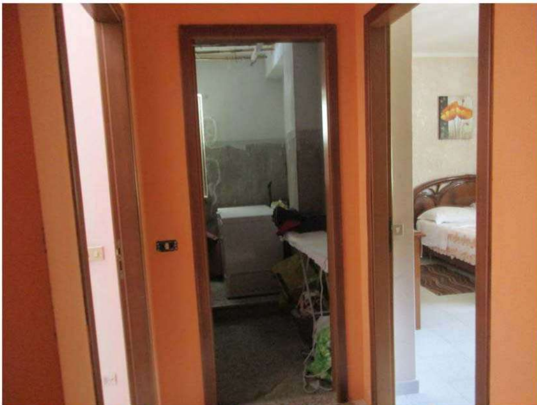
Foto 44: Vista dal disimpegno sulle stanze – di fronte il servizio igienico non ultimato
