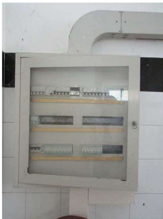
Foto 40: Particolare del quadro elettrico
