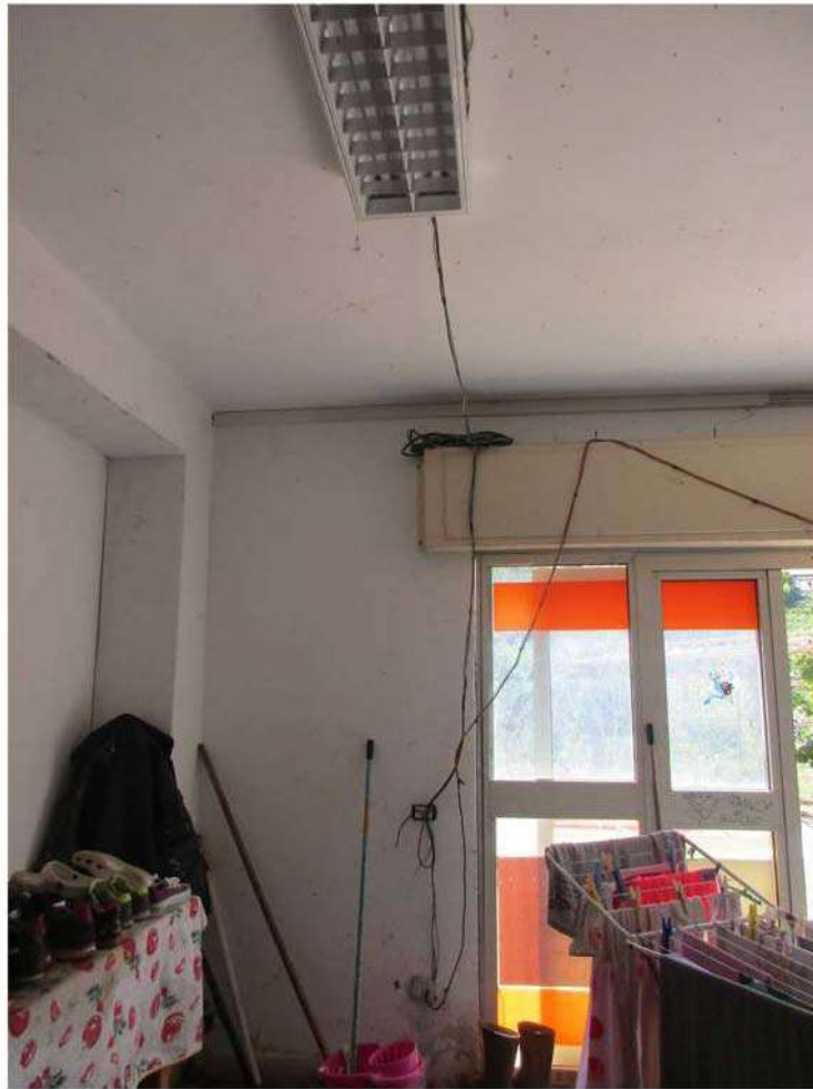
Foto 15: Condizione dell'impianto elettrico
