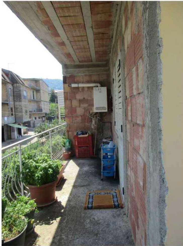
Foto 55: Il balcone sul fronte nord: si noti l'assenza sell'intonaco esterno
