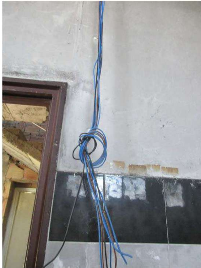
Foto 31: Altra immagine descrittiva dell'impianto elettrico
