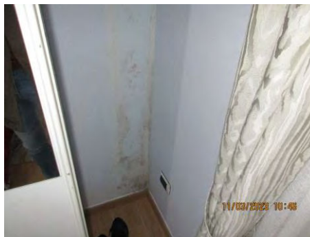
Foto n. 12 – Camera da letto- Presenza di umidità
