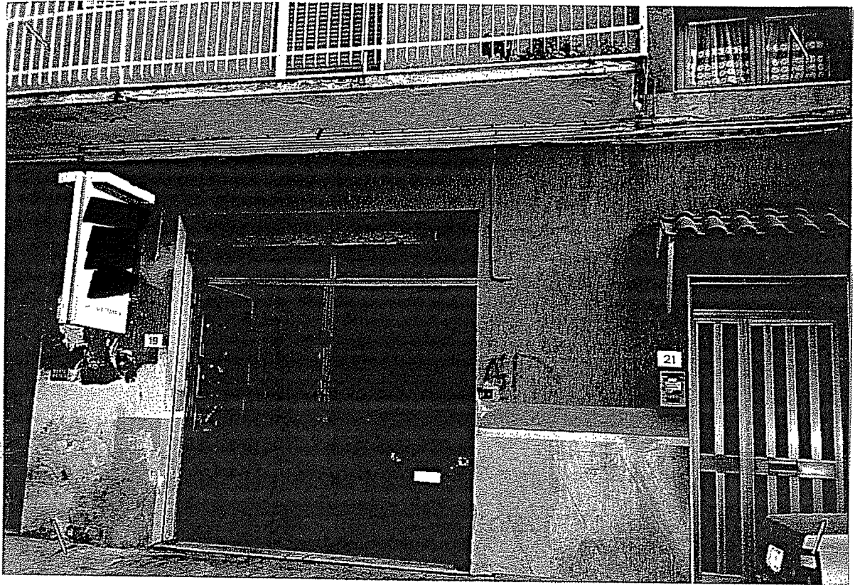
Comune di San Pietro e Maiola fg. 13 part. 1215 sub 1 Locale Piano Terra utilizzato per l'attività di elettauto. Foto n° 1
