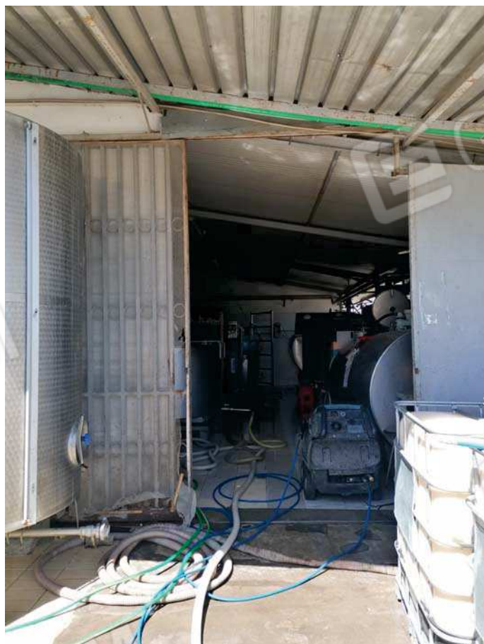
FOTO 17. Ingresso locale tecnico
