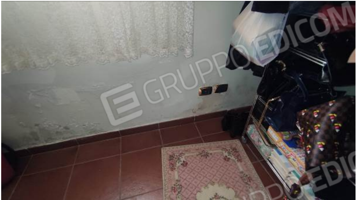
Foto n° 50: Piano Seminterrato – ripostiglio – particolare umidità di risalita
