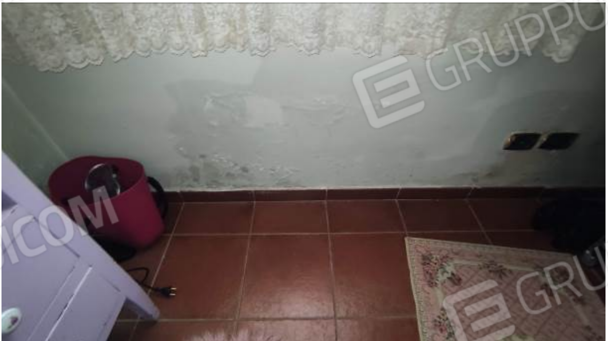
Foto n° 49: Piano Seminterrato – ripostiglio – particolare umidità di risalita
