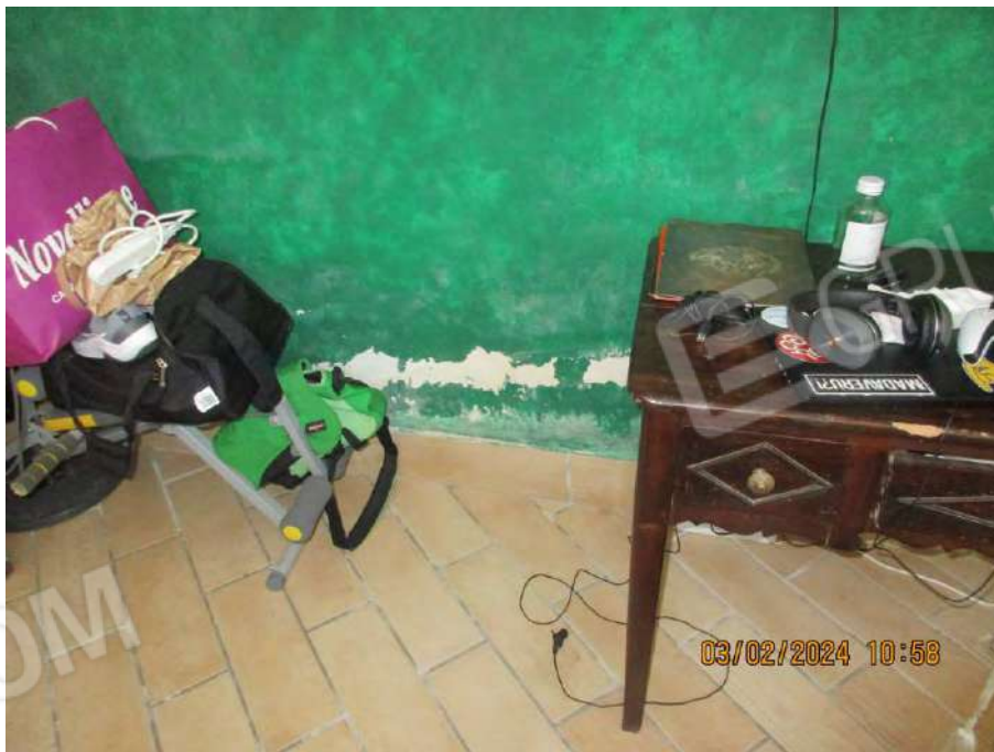
Foto n. 6 – Piano terra - Camera da letto n. 2 – Umidità
