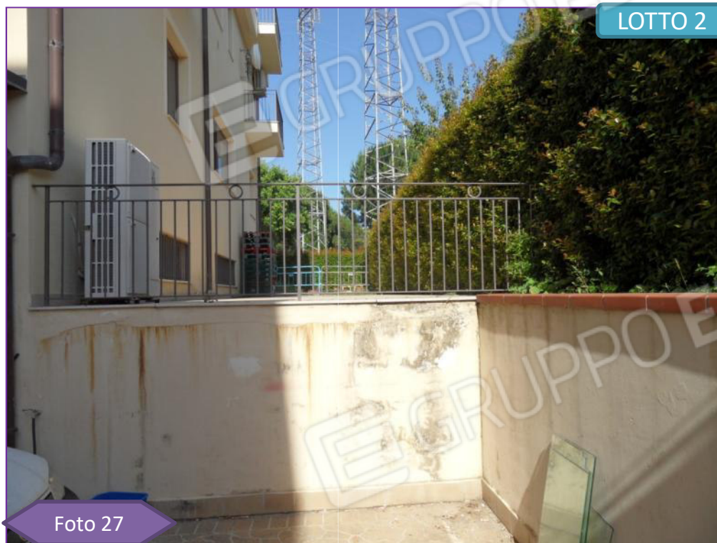
Parte terminale della rampa. Nella zona Sud del fabbricato è stato ricavato piano calpestabile a livello del Piano Terra, con lo spazio sottostante a disposizione del Piano Seminterrato, anche se avente altezza utile di 1,31 ml.
