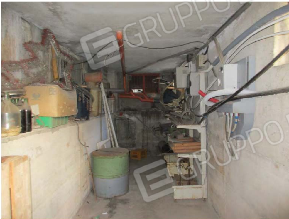
Foto n.°83 – Sub 3 – Locale tecnico
