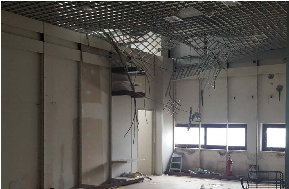
INTERNO (CONTROSOFFITTI VANDALIZZATI)
