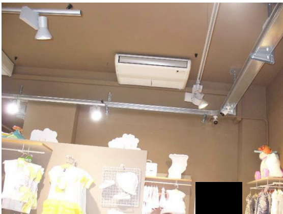
FOTO N. 42 – impianto di illuminazione e condizionatore-
