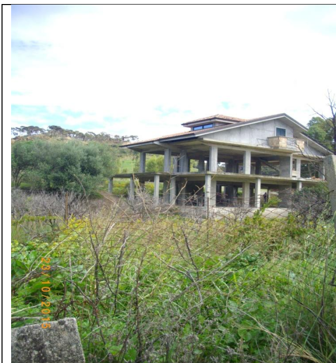
vista dalla strada provinciale dello spigolo tra fronte sud- ovest / nord ovest
