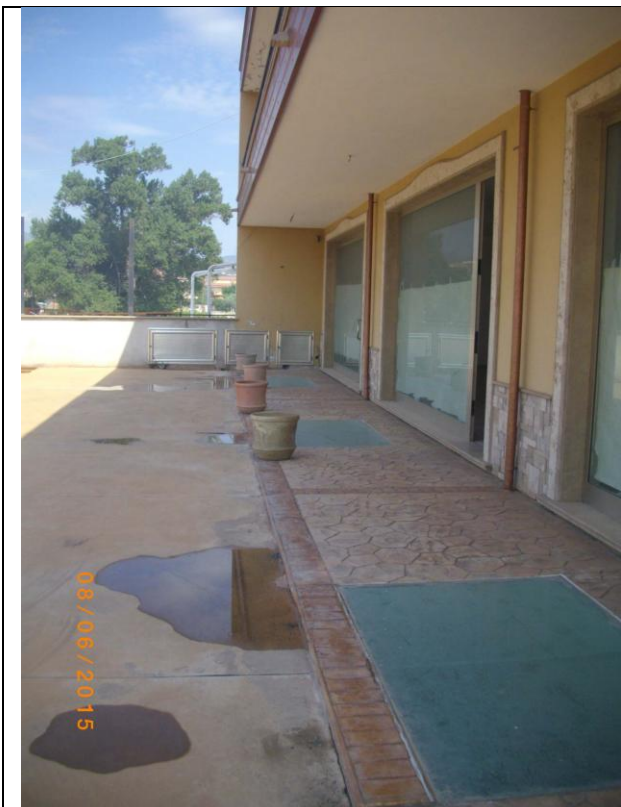
Veduta esterna delle due vetrine e del piazzale esterno , sullo sfondo si notano i pannelli delle cassette di distribuzione dell'impiantistica
