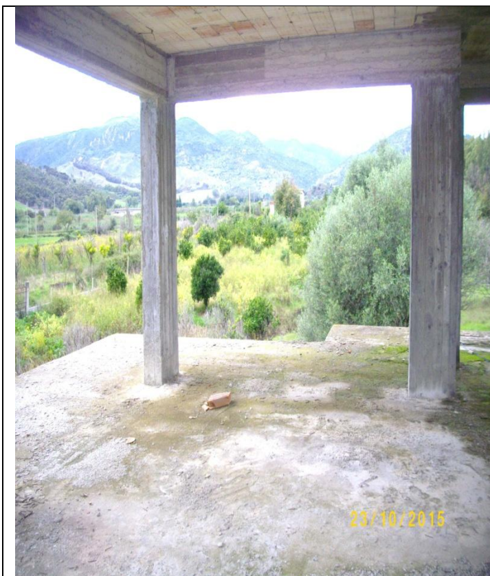
particolare del piano Primo ( pilastri e soletta) con veduta verso la strada provinciale ( spigolo nord- ovest )
