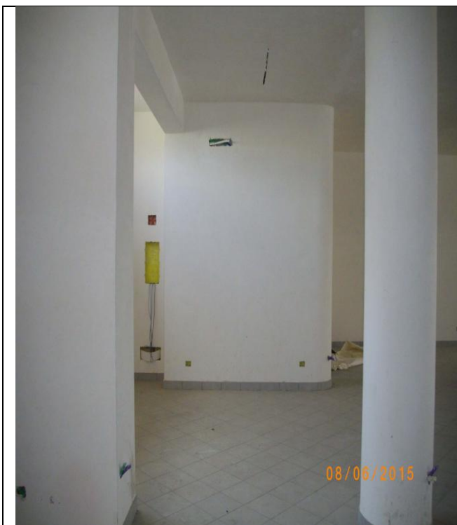
Veduta Interna , si nota il quadro Elettrico, i Cavi ( in comune ) dell'impianto elettrico , si nota ancora CHE NON C'E' divisione con il sub. adiacente , e che ci sono le condutture per l'aria condizionata
