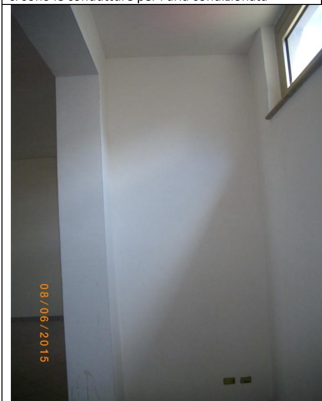
Stessa Veduta Interna ma di lato si nota oltre all'infisso a Vasistas si NOTA la parte Abusiva ( quella tra il pilastro posto sul lato sinistro e l'infisso posto sul lato destro)
