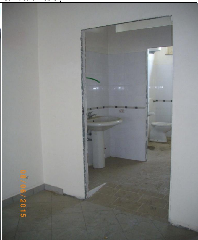
Veduta Interna del bagno disabili , si nota che mancano gli infissi , che si sono i sanitari e che è per disabili
