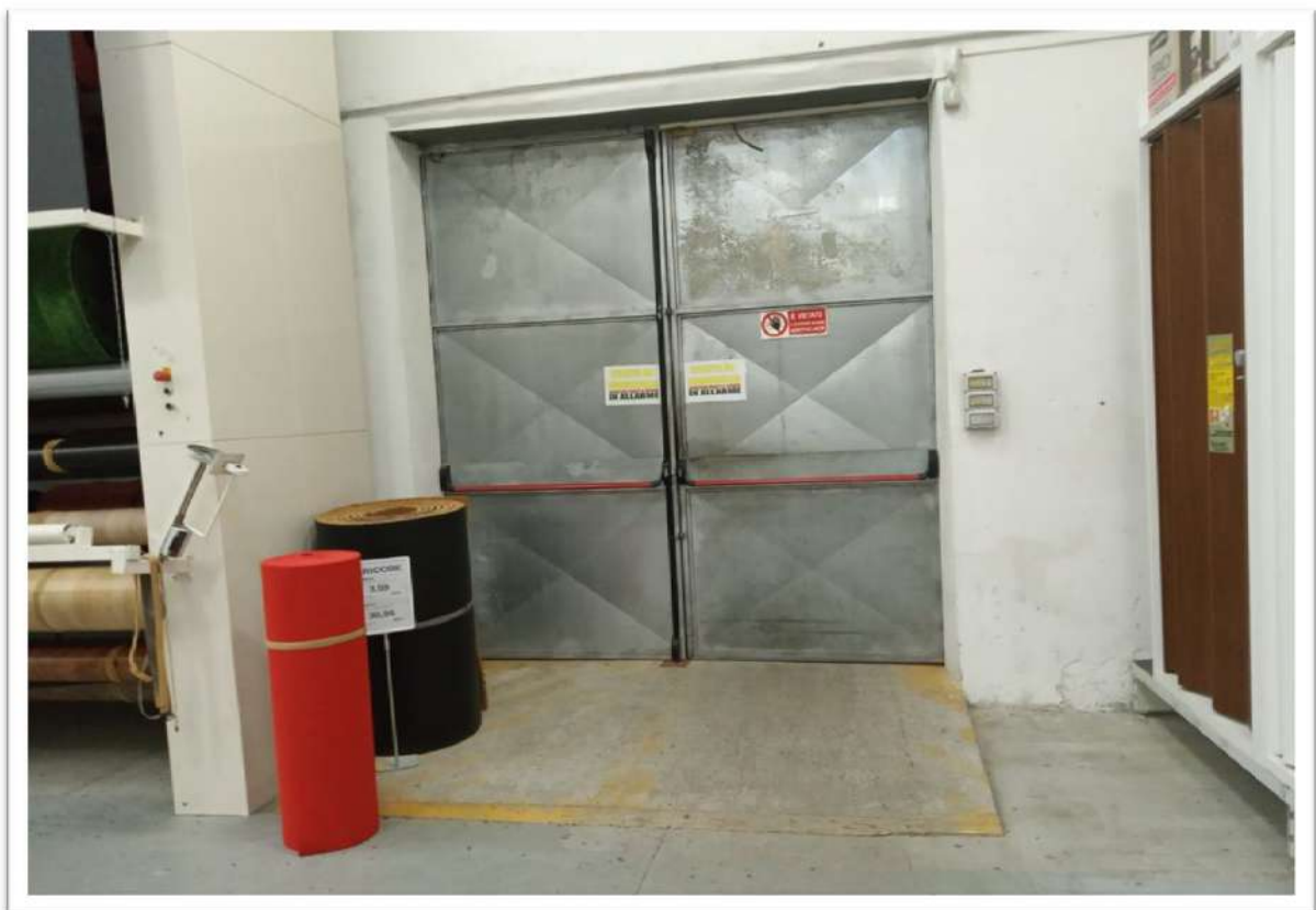
FOTO 12 Porta di accesso al capannone ubicato sulla part.IIa 1398 ARCH. LUCIA SACCA' - CTU -
