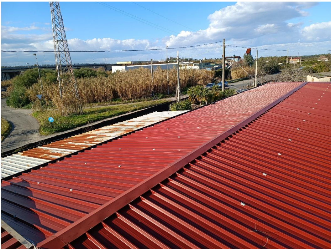
Foto 8: Catasto Terreni di San Ferdinando, foglio 17, particella 654 sub 4, Contrada Focoli. Lastrico solare sul quale è stata appoggiata una copertura a falde inclinate realizzata con struttura di ferro e copertura di lamiera grecate.
