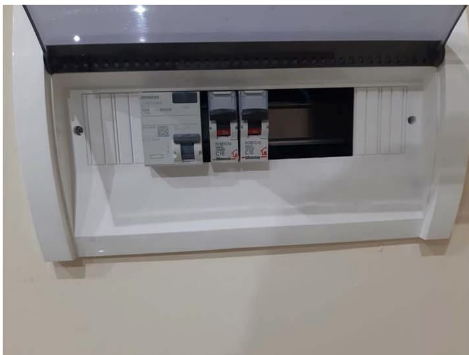
Foto n° 7 – Quadro elettrico al pian terreno
