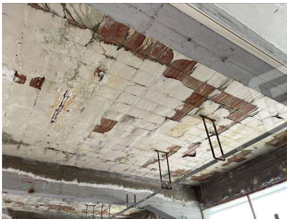
FOTO 9 – stato di degrado dei solai di copertura
