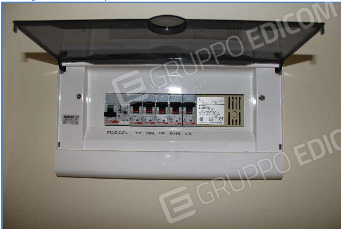
2.5- Zona giorno – Particolare su quadro elettrico, funzionante
