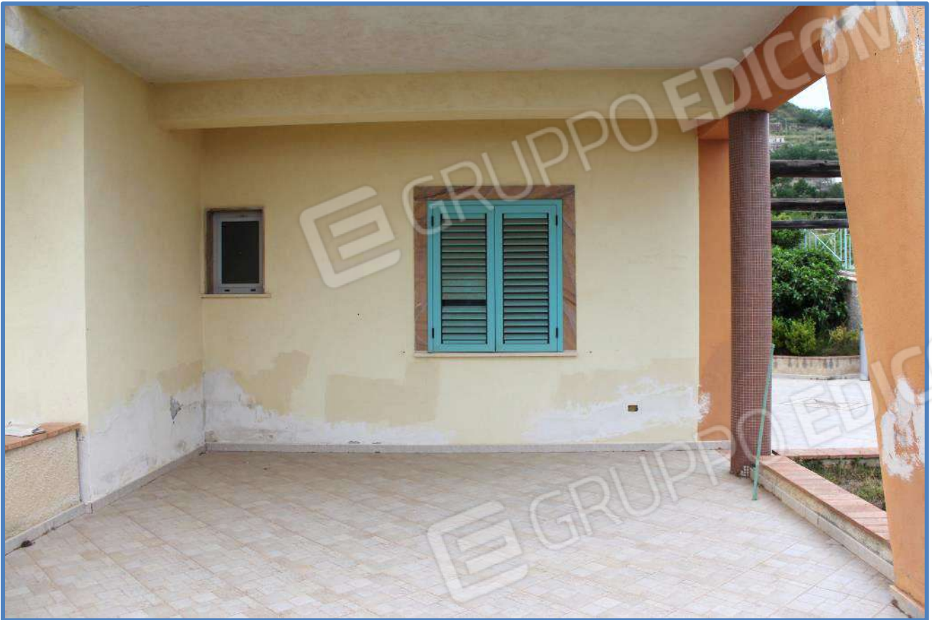
8.7- Corte di pertinenza esclusiva (p.lla 731/17), vista verso il lato opposto – visibili tracce di umidità
