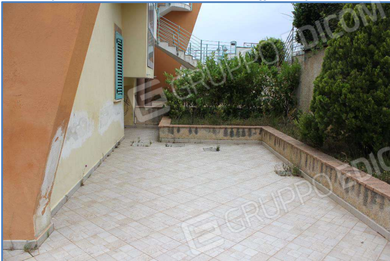
8.5- - Corte di pertinenza esclusiva dell'abitazione, visibili tracce di danneggiamento superficiale dell'intonaco
