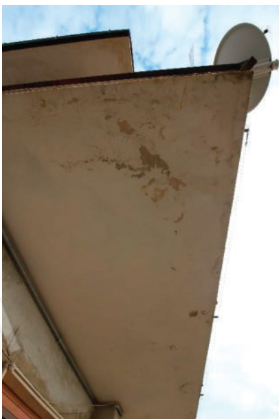
Foto 9: Particolare balconi con infiltrazioni d'acqua
