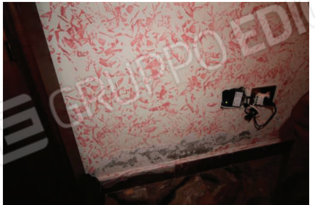
Foto 30: Particolare umidità ed impianto elettrico soggiorno
