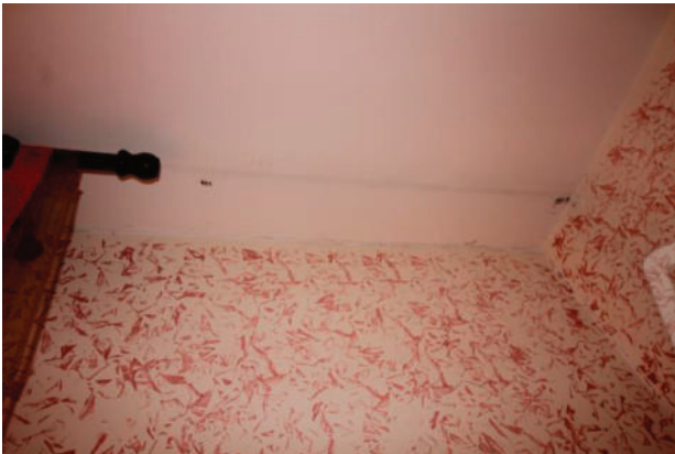
Foto 29: Particolare presenza di umidità soggiorno
