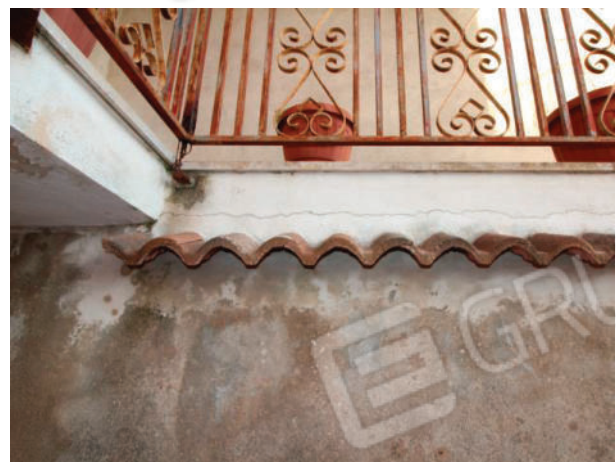
Foto 6: Particolare montante ringhiera completamente corrosa dalla ruggine
