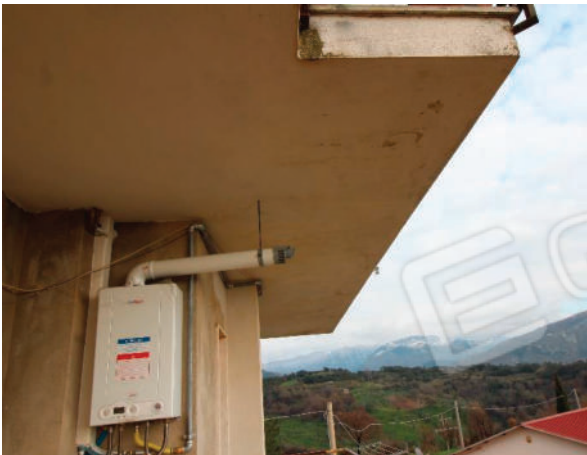
Foto 7: Particolare balconi con infiltrazioni d'acqua
