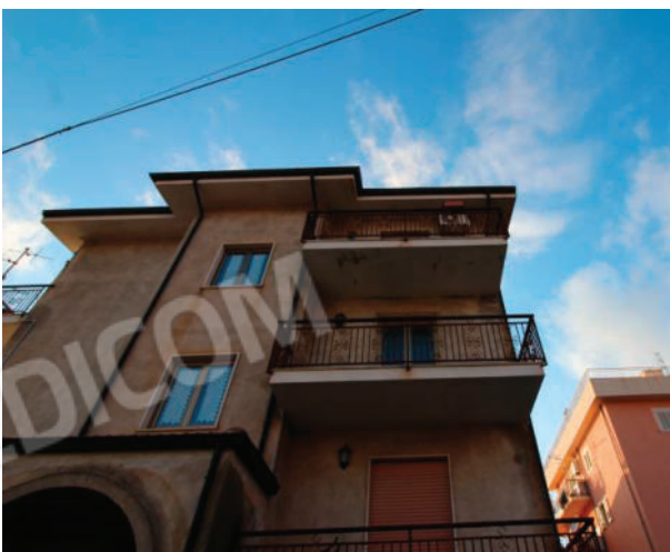
Foto 11: Particolare balconi con infiltrazioni d'acqua
