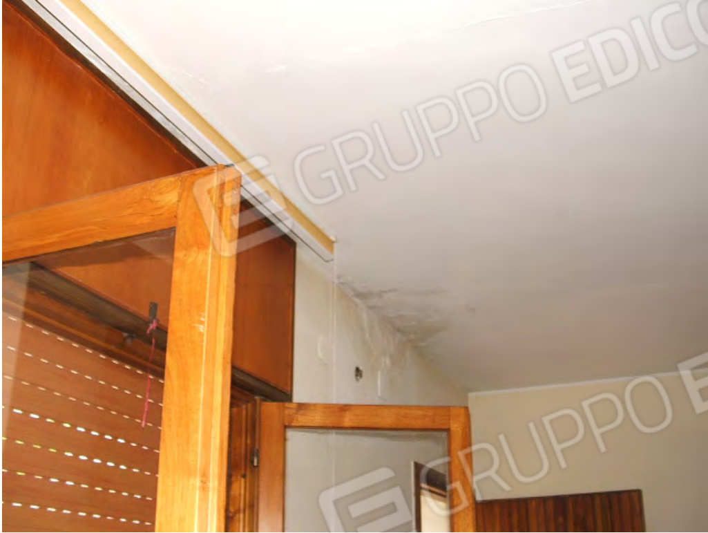
Infiltrazione acqua piovana dalla copertura
