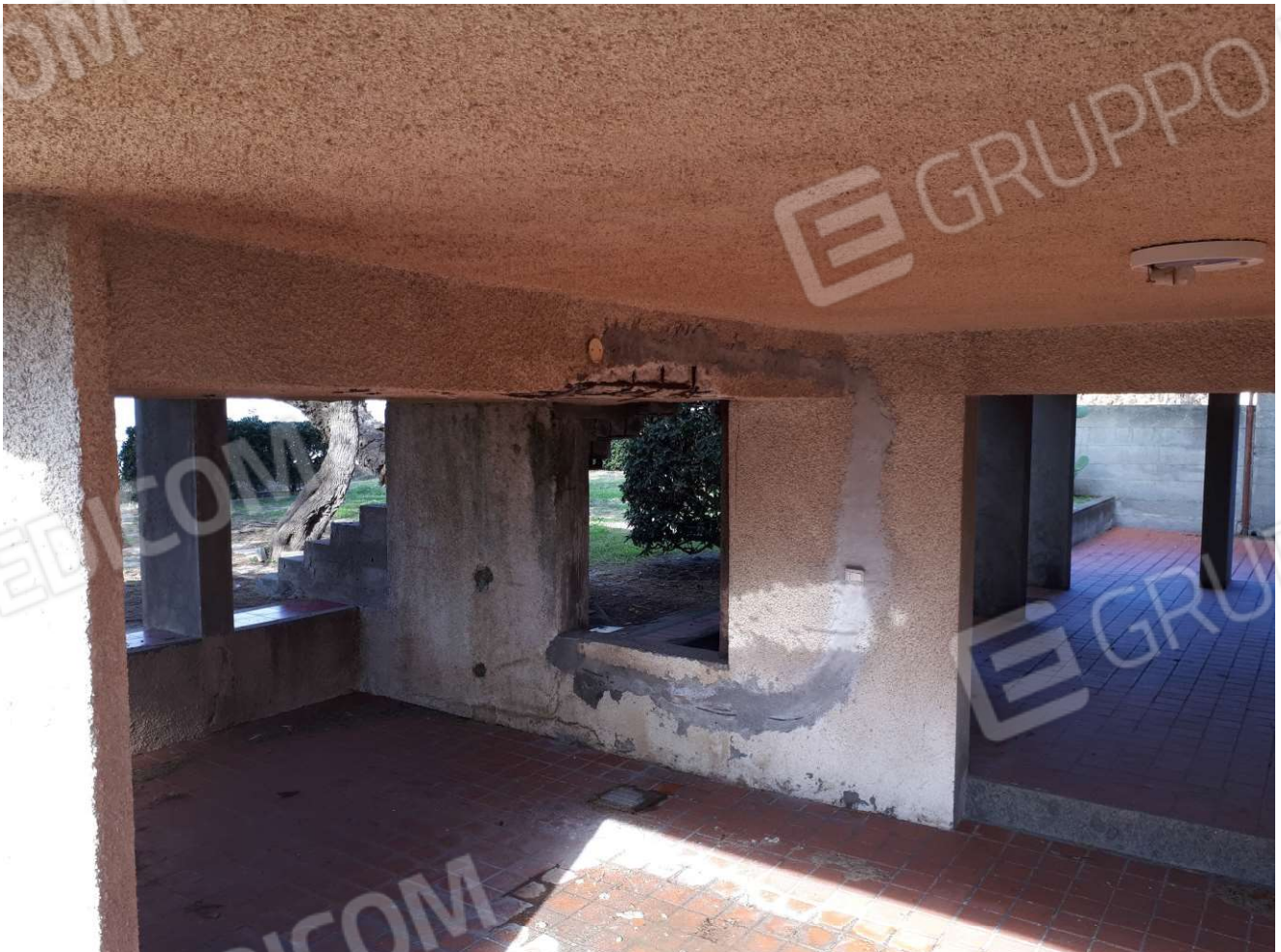
FOTO 10 – PARTICOLARE PORZIONI DI STRUTTURA FATISCENTI
