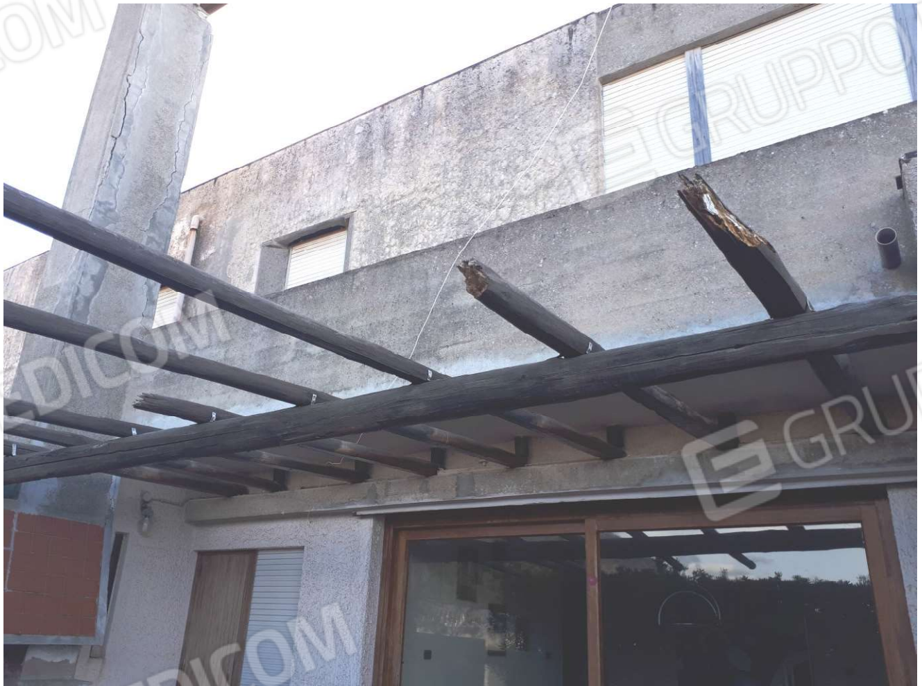
FOTO 8 – PARTICOLARE PORZIONI DI STRUTTURA FATISCENTI
