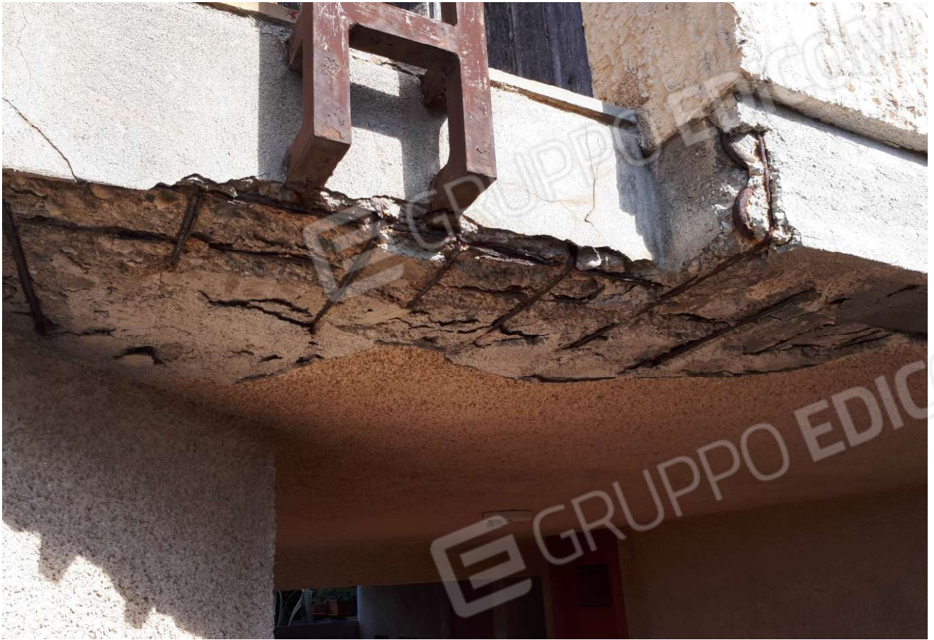
FOTO 7 – PARTICOLARE PARTE STRUTTURALE FATISCENTE
