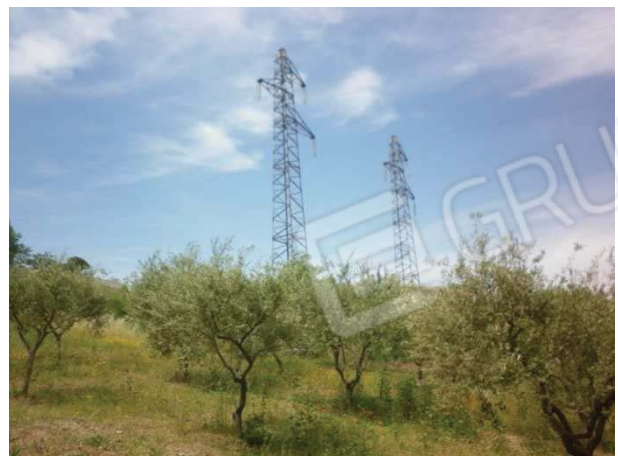
Foto 16 - P.Ila 40, tralicci elettrodotto
