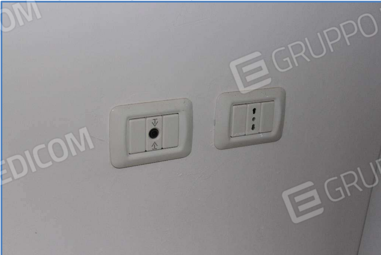
2.18- Particolare placche elettriche con presa e attacco segnale antenna
