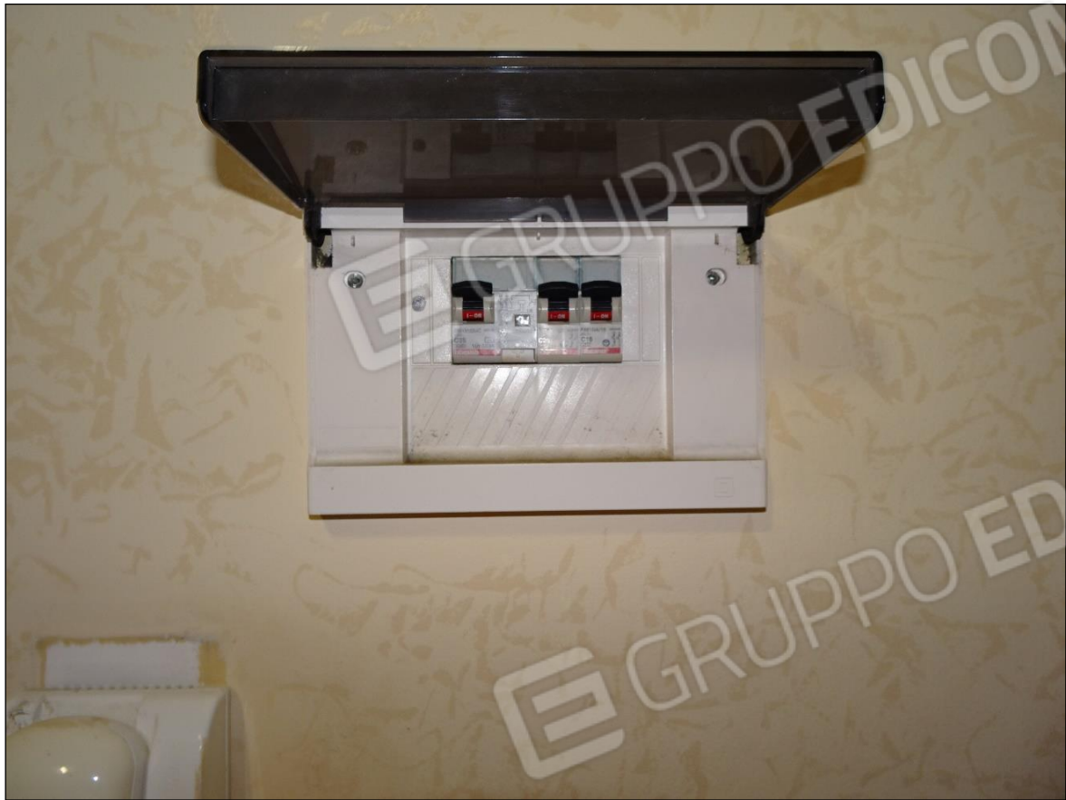
Foto 11: Vista particolare quadro elettrico appartamento
