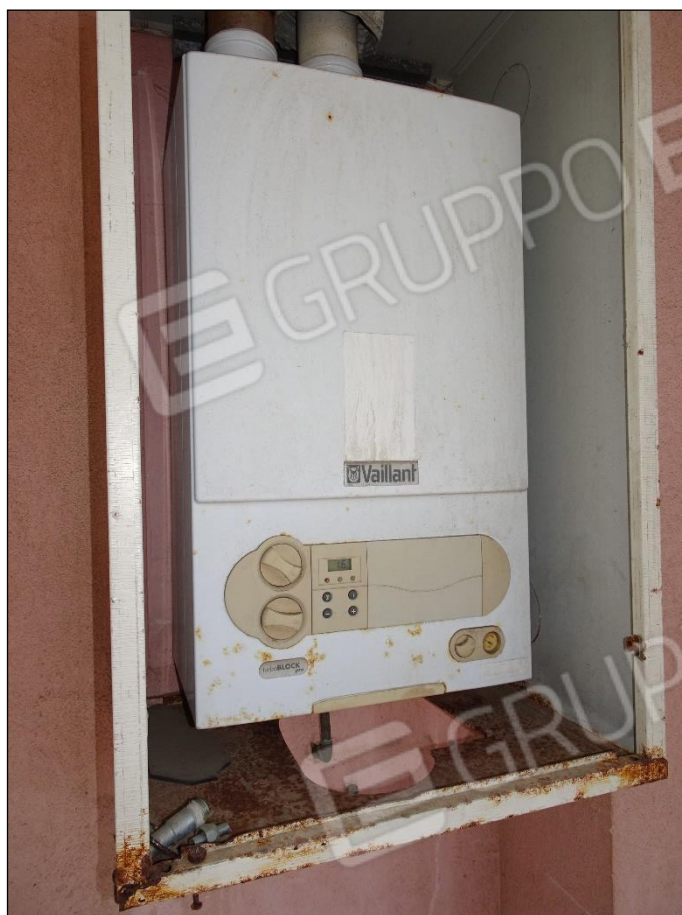
Foto 17: Vista particolare caldaia appartamento
