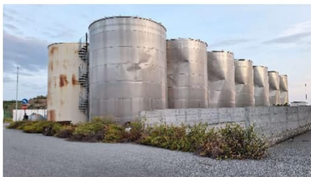
Vista dei silos in acciaio ed acciaio inox
