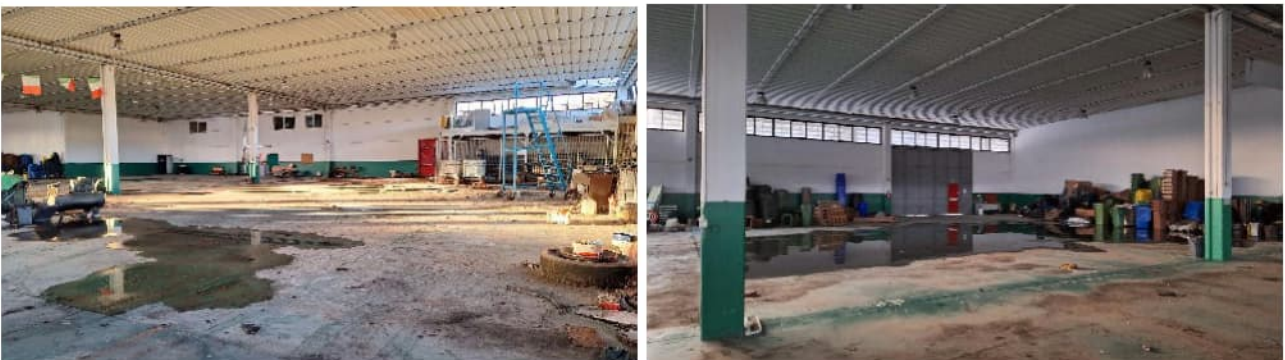
Infiltrazioni dal tetto capannone B
