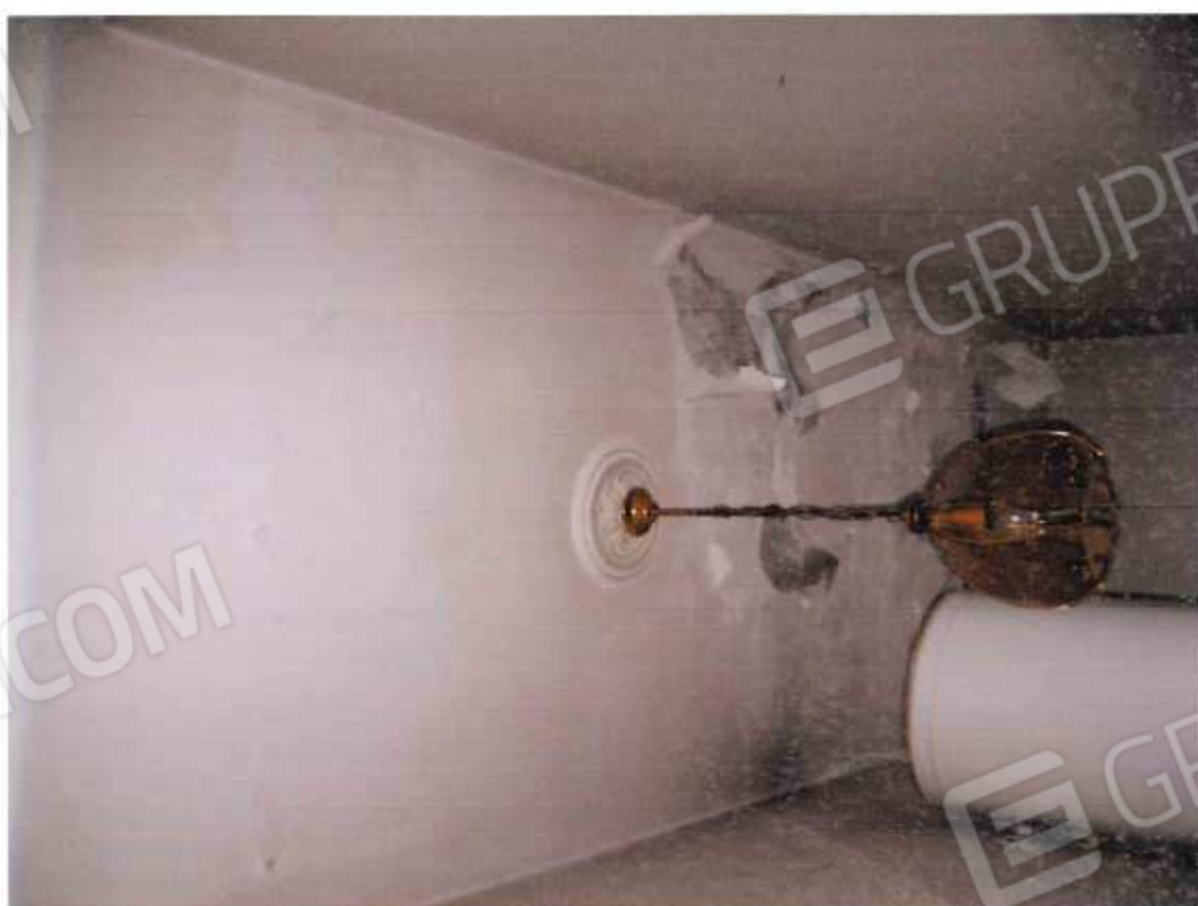
Foto 16– Vecchie infiltrazioni nel soffitto del bagno
