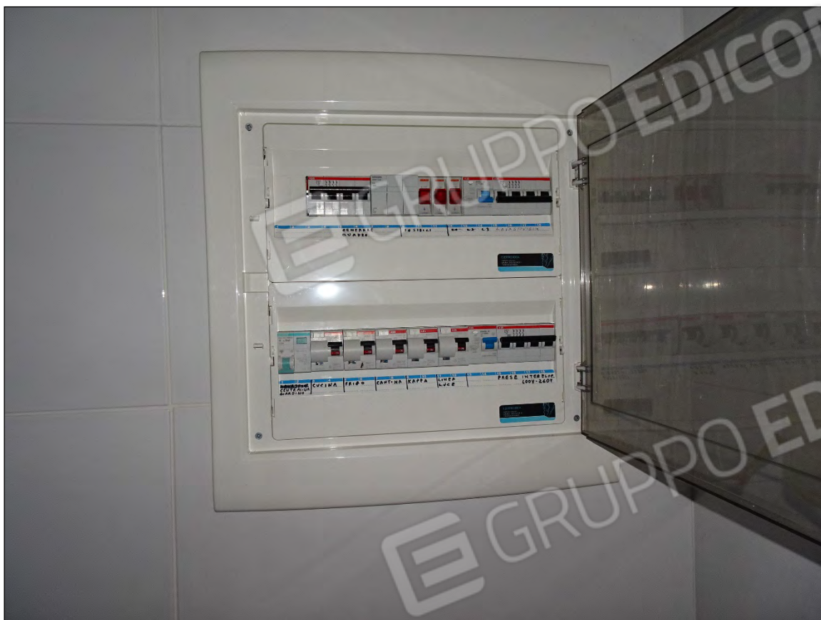
Foto 55: Vista vano cucina immobile piano terra sub 9 - particolare quadro elettrico
