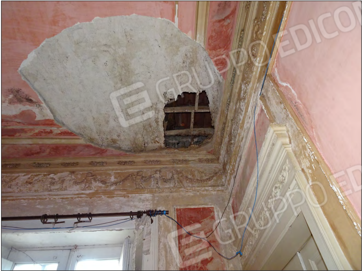
Foto 101: Particolare soffitto vano 6 immobile piano primo sub 10
