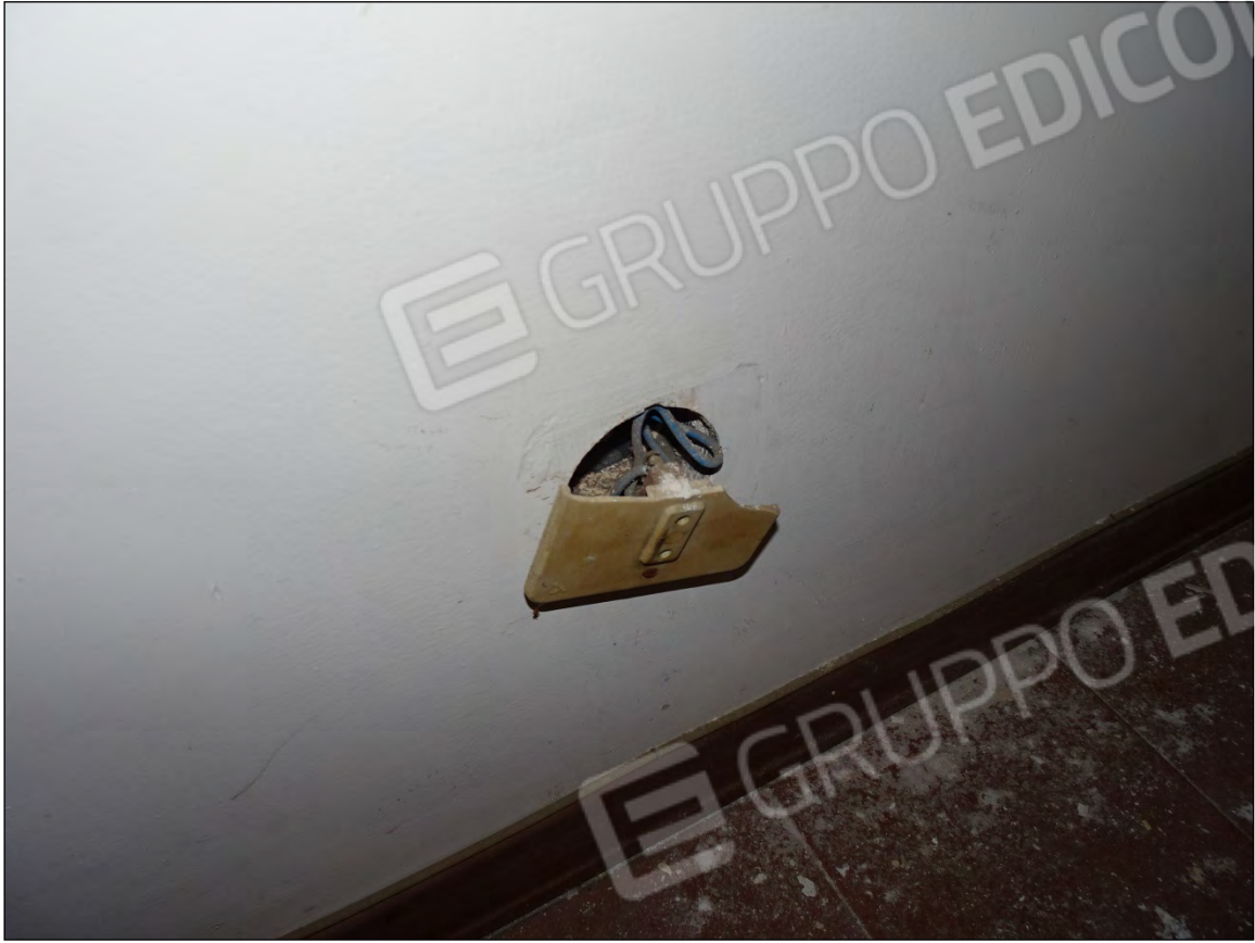
Foto 111: Particolare presa elettrica vano interno immobile piano primo sub 10
