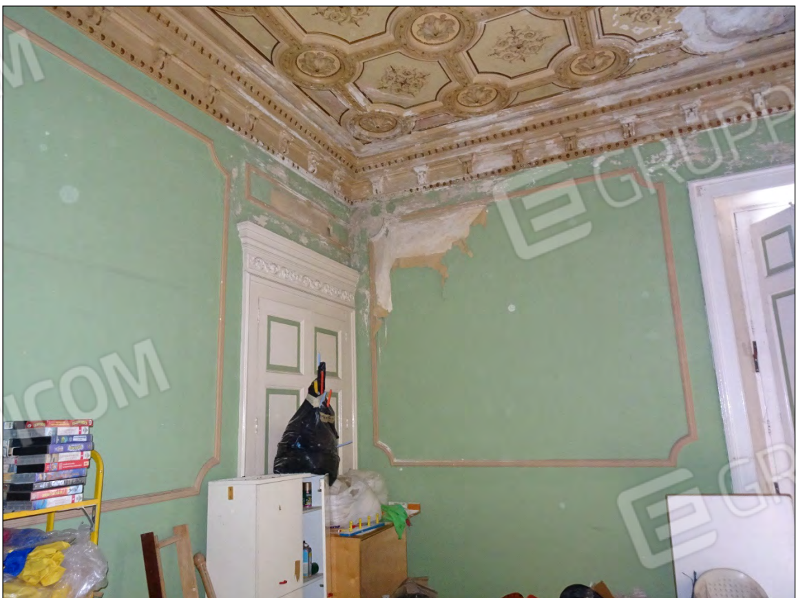
Foto 108: Particolare soffitto vano 5 immobile piano primo sub 10
