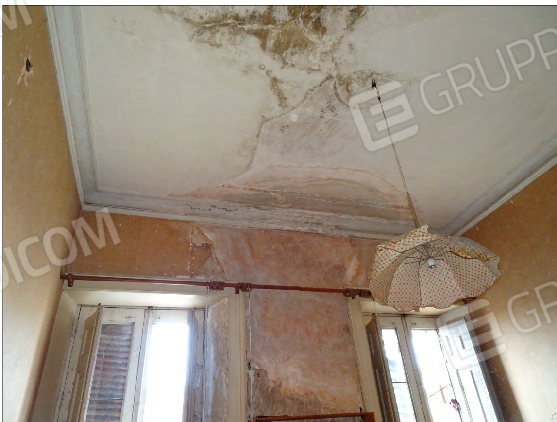
Foto 116: Particolare soffitto vano 3 immobile piano primo sub 10
