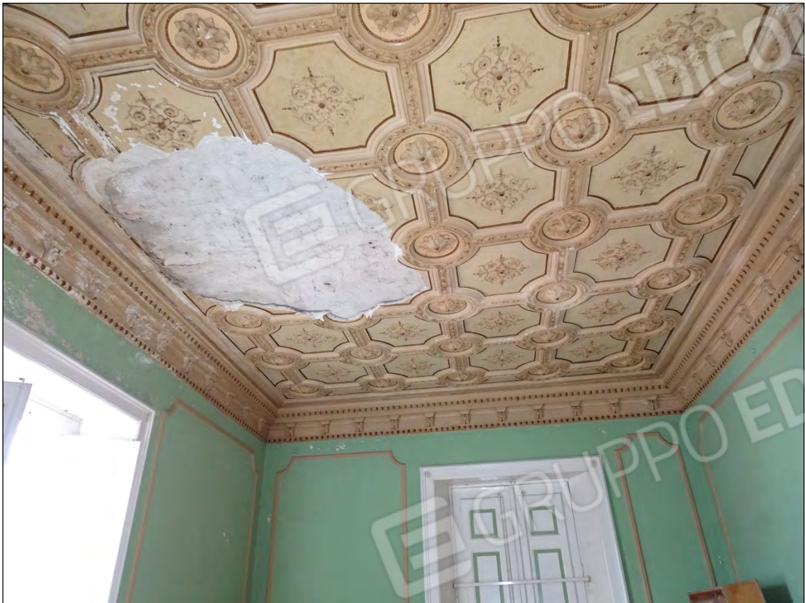
Foto 107: Particolare soffitto vano 5 immobile piano primo sub 10
