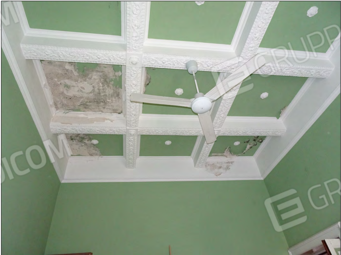
Foto 126: Particolare soffitto vano 1 immobile piano primo sub 10
