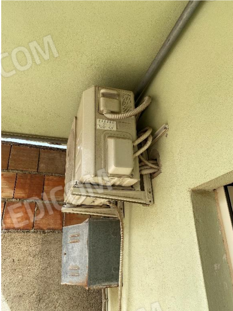
Foto n.28, n. 29– Unità esterna climatizzatore, Finiture
