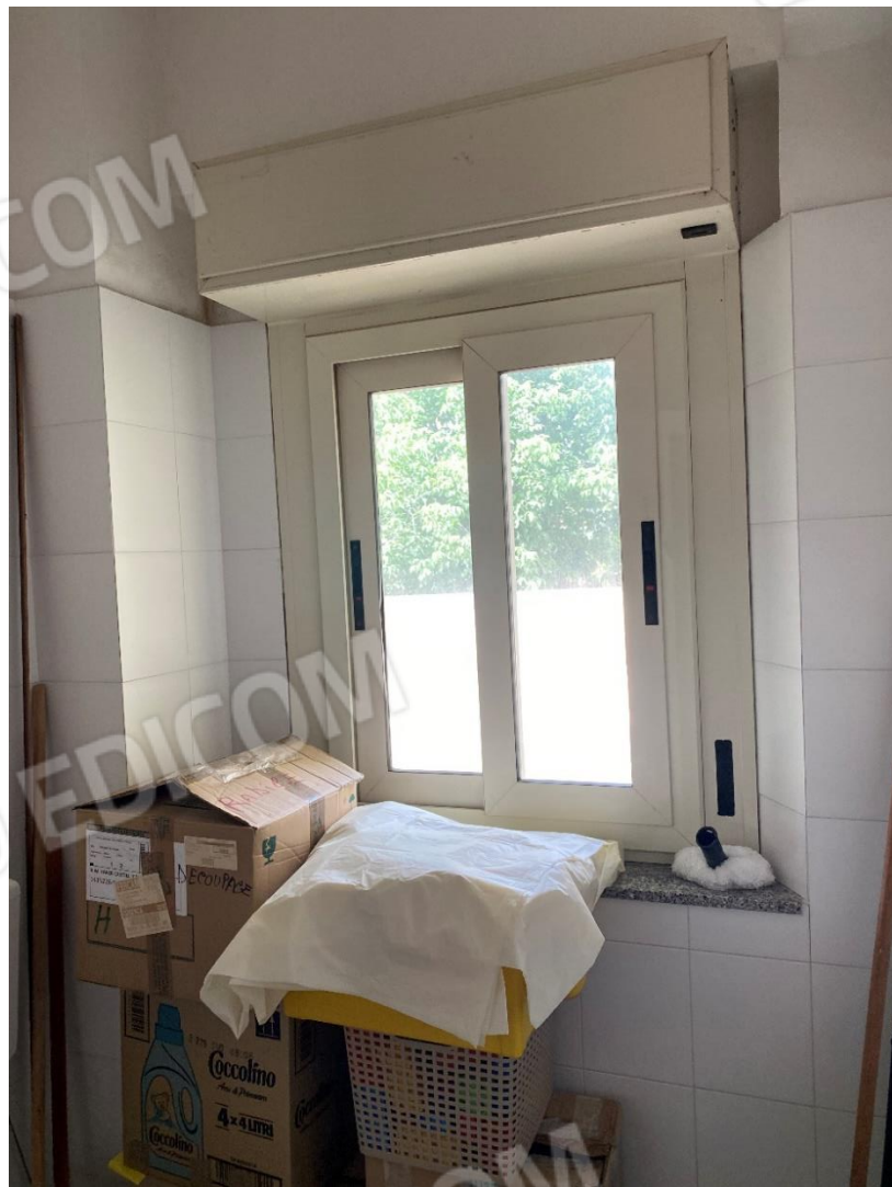
Foto n. 20 – n.21 – infissi Bagni
