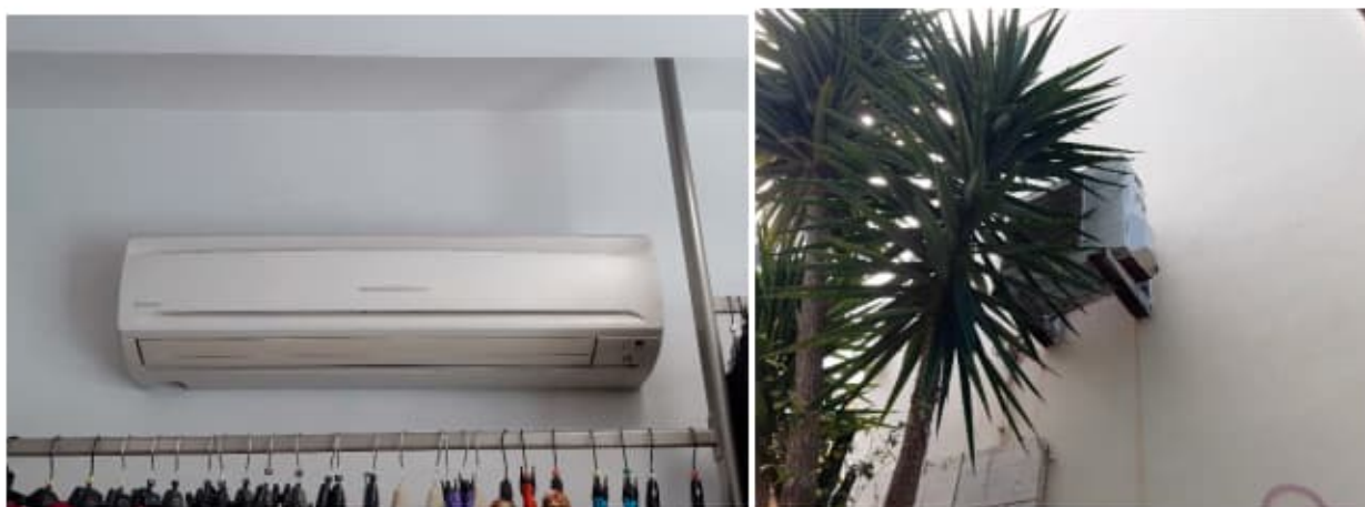
Figura 7: Inverter DAIKIN rilevato in sede di sopralluogo
