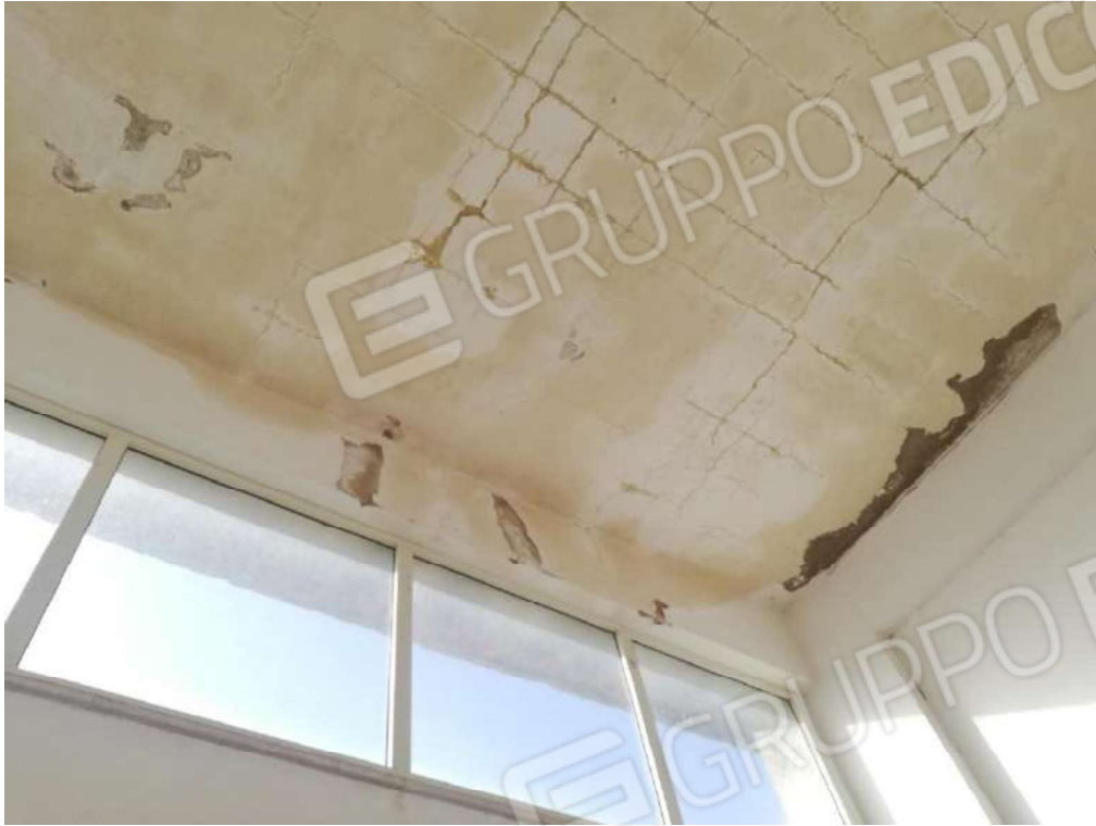
Foto 51. Vista dei locali interni: ambiente 1. Particolare del soffitto interessato da copiose infiltrazioni d'acqua provenienti dalla copertura.
