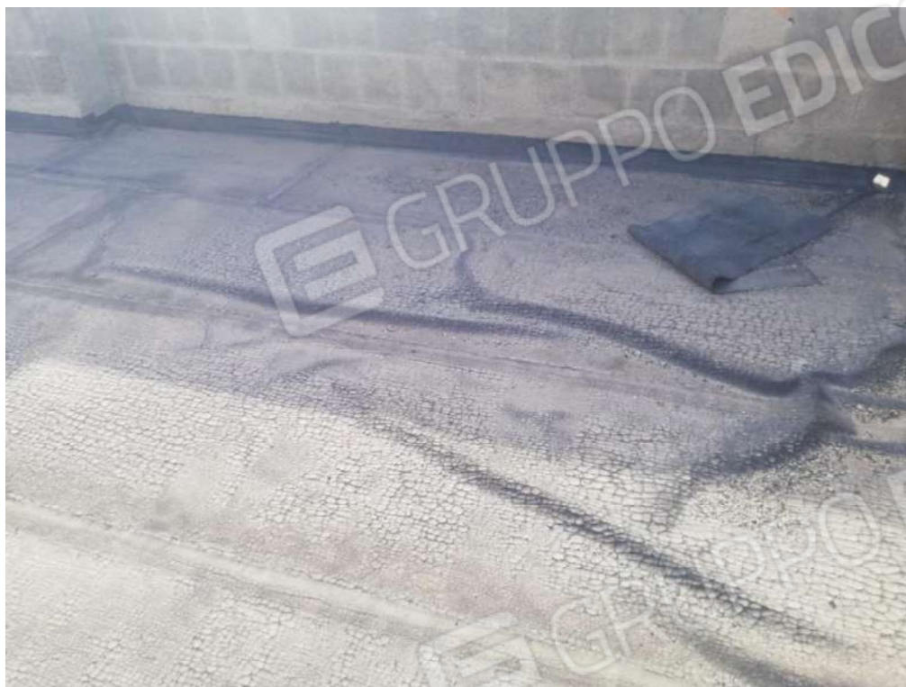
Foto 69. Vista del lastrico solare: particolare della guaina bituminosa ammalorata.
