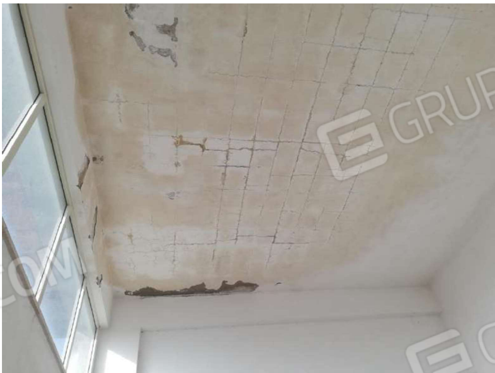
Foto 52. Vista dei locali interni: ambiente 1. Particolare del soffitto interessato da copiose infiltrazioni d'acqua provenienti dalla copertura.
