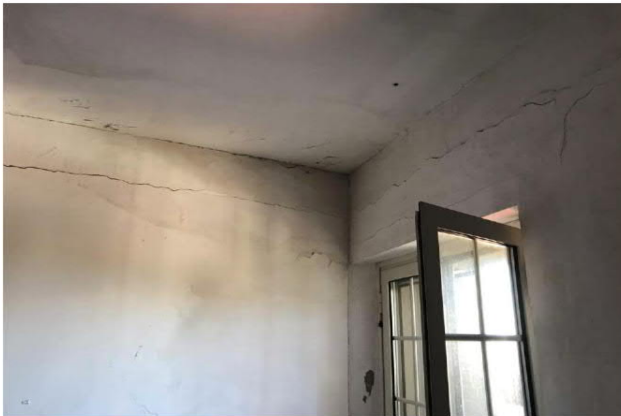
Piano Secondo – Lesioni e Fessurazioni
