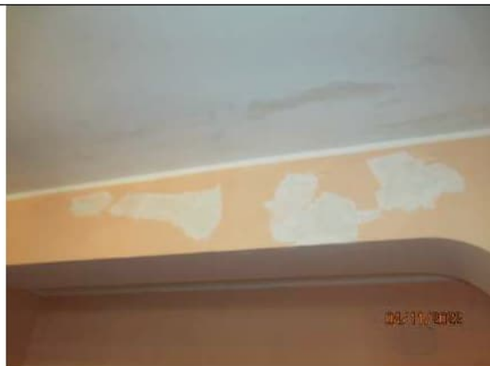
Foto 32. Particolare delle tracce di umidità presenti sul soffitto del soggiorno/pranzo
