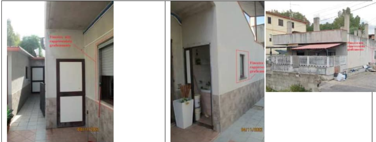
Diffformità come evidenziata al punto 1
