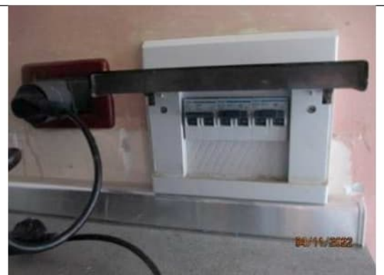
Foto 11. Particolare del quadro elettrico presente in cucina
