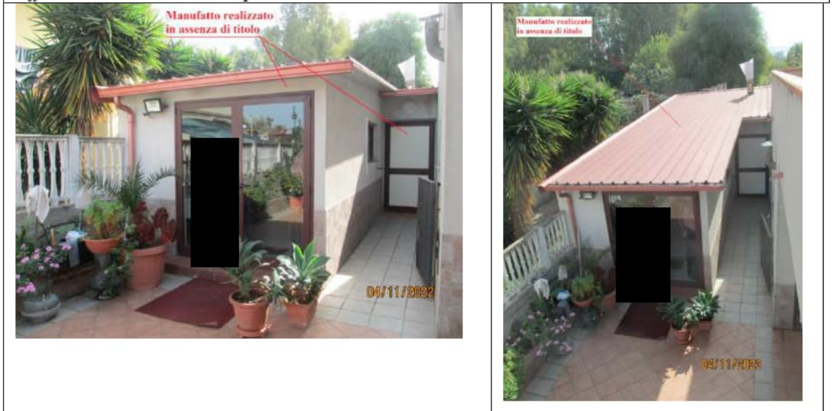
Diffformità come evidenziata al punto 2
