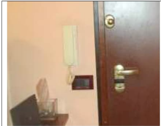
Foto 12. Vista del presente impianto citofonico
