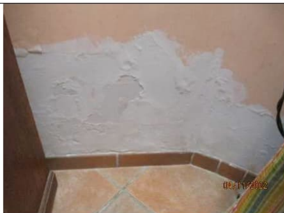
Foto 34. Particolare delle tracce di umidità di risalita presenti sulle pareti, in corrispondenza del pavimento
