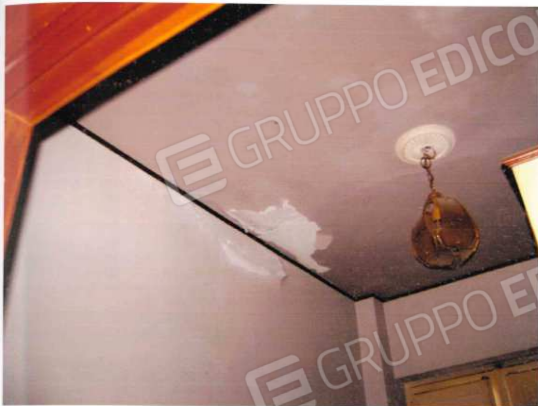
Foto 21 – Particolare vecchie infiltrazioni nel soffitto della camera da letto piccola
