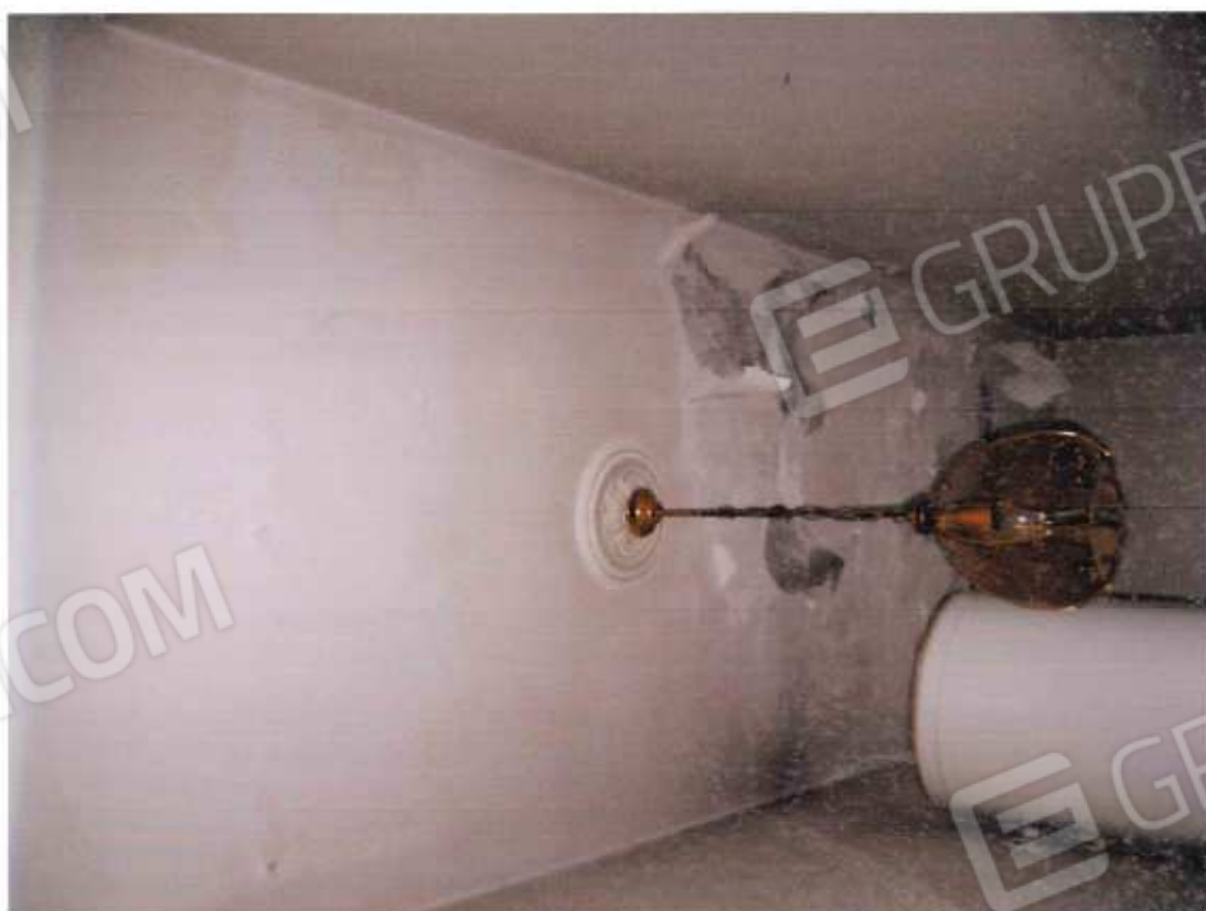
Foto 16– Vecchie infiltrazioni nel soffitto del bagno
