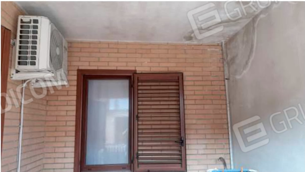
Infiltrazione di acque meteoriche nella veranda al piano primo, provenienti dal terrazzo.
