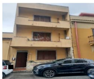
Prospetto difforme da quello di progetto (Portone, Finestra, Balconi 1° e 2° piano)
