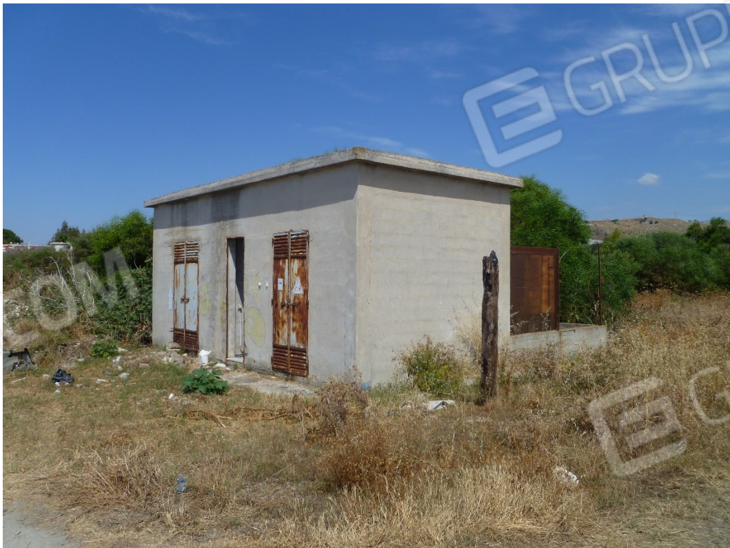
Foto n° 48 Cabina elettrica (particella 261)
