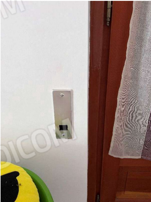
Foto 49 – Dettaglio serramento non funzionante
