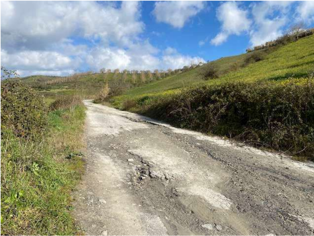
In evidenza strada provinciale dissestata
