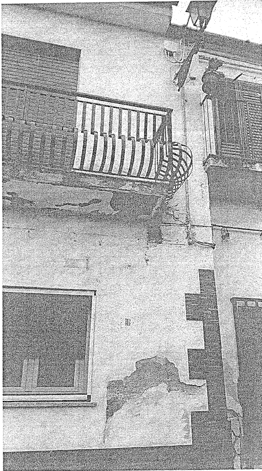
Figura 3: Foto esterna_ Deterioramento balcone esterno
