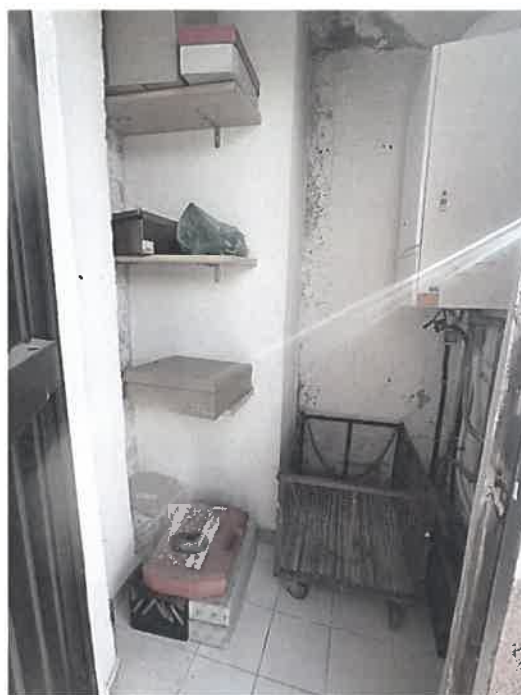
foto n. 20 - veduta vano caldaia
