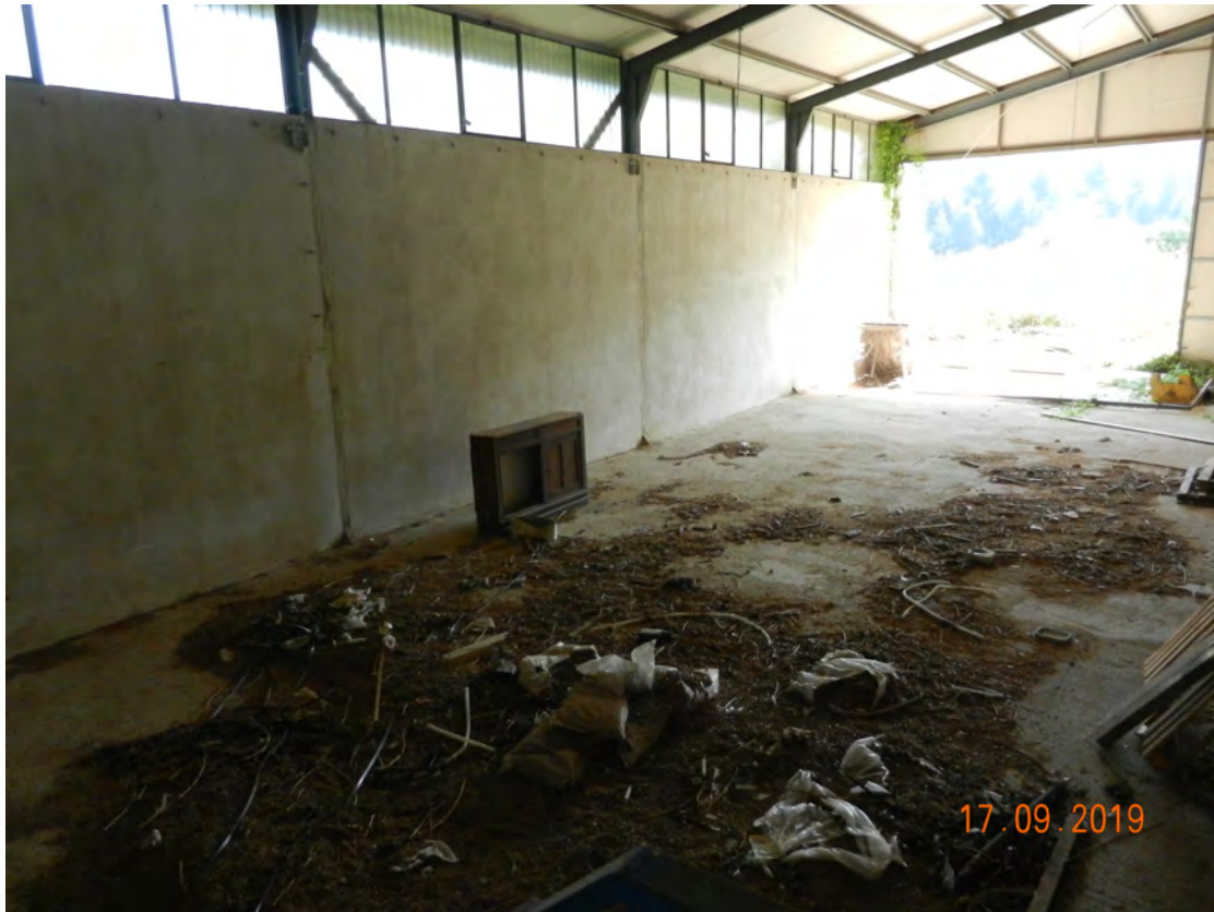
Foto 10 deposito legna fg. 10 - p.lla 467
