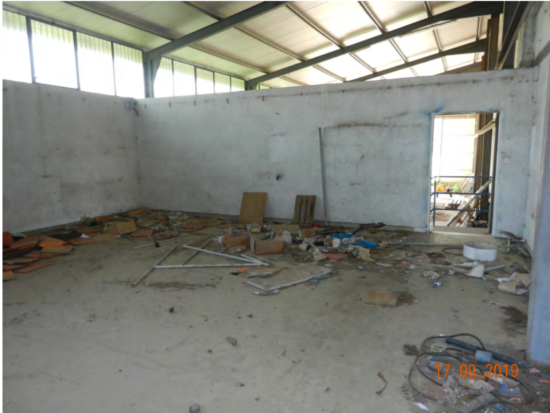
Foto 8 deposito legna fg. 10 - p.lla 467
