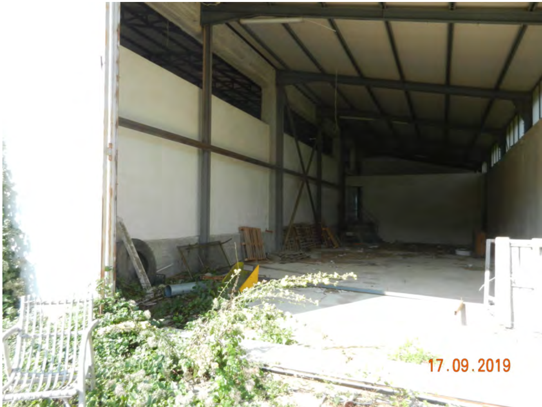
Foto 9 deposito legna fg. 10 - p.lla 467
