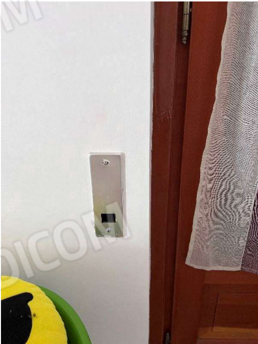
Foto 49 – Dettaglio serramento non funzionante
