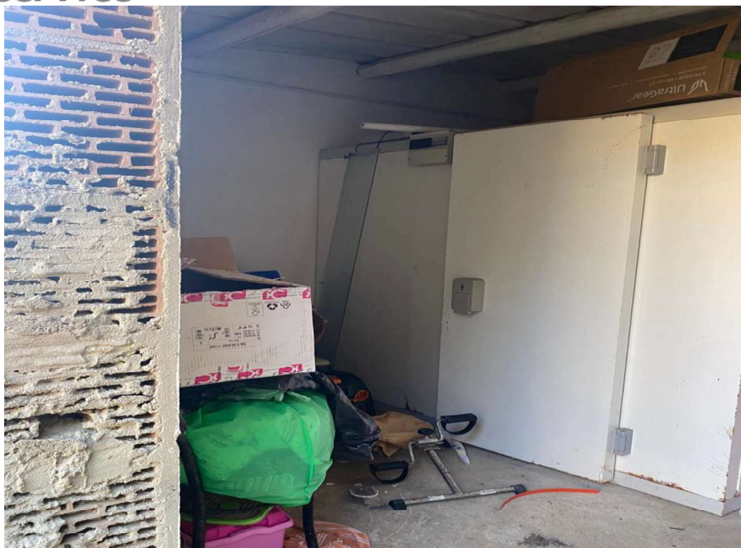
Foto n. 27 Manufatto abusivo, adibito a deposito
