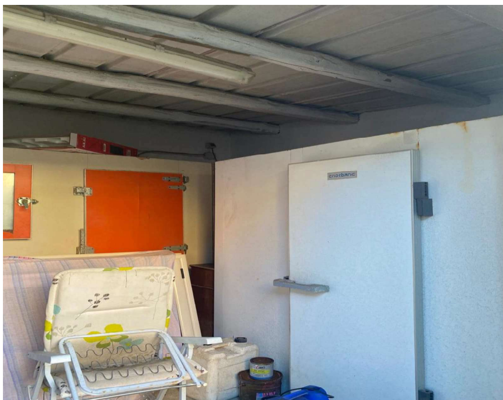
Foto n. 28 Manufatto abusivo, adibito a deposito
