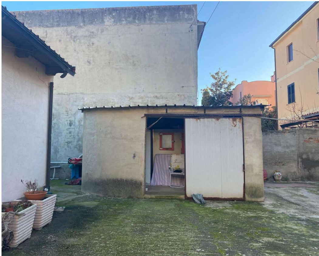
Foto n. 26 Manufatto abusivo, adibito a deposito
