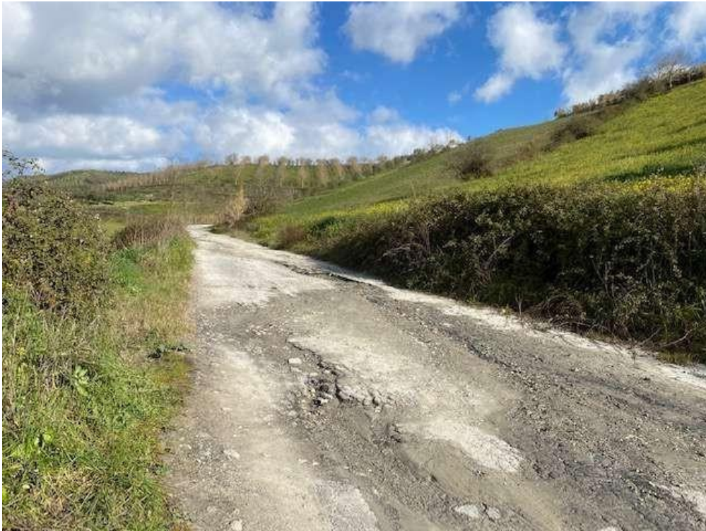
In evidenza strada provinciale dissestata
