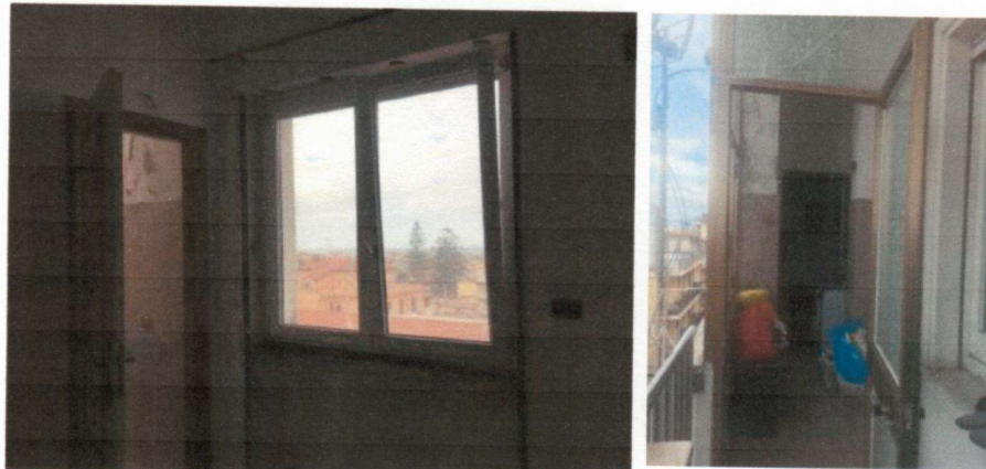
Secondo bagno (difformità) - Accesso da camera padronale (in alto a sx) - Accesso da balcone (in alto a dx). (Allegato 8 - Rilievo fotografico).
